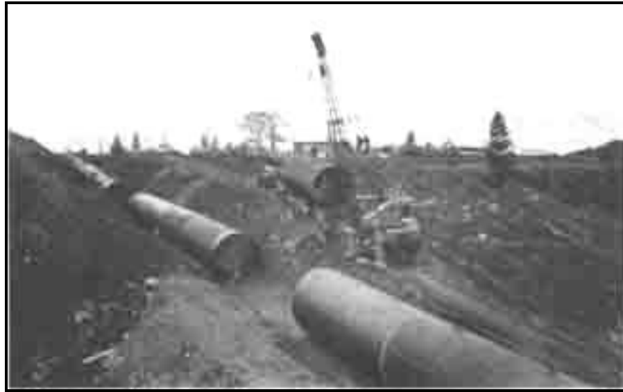
Fig. p. 99b. La mise en place de l'amenée d'eau alimentant la centrale hydroélectrique de la compagnie. Source : La Pulperie de Chicoutimi.
